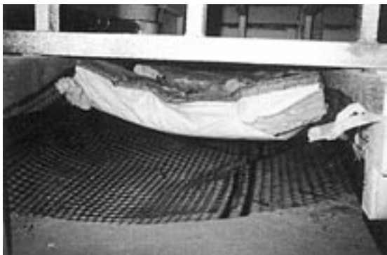
施工不良で断熱材と受け材のネットが脱落していた例。断熱材は何の役割も果たしていない
