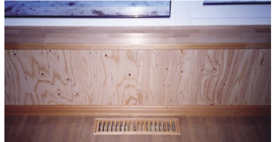
基礎断熱した床下でカビが発生すると、1階床のガラリを通じてカビ臭い空気が室内に流入する可能性がある
