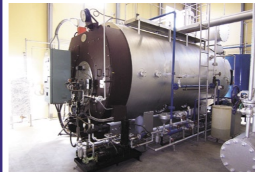
旭川市内でも最大級のボイラーを設置
