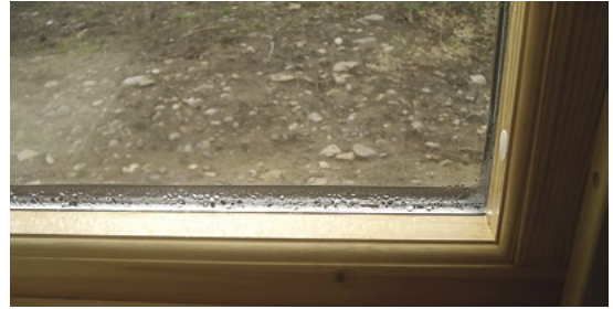
本格的な冬の前に結露が発生した窓
