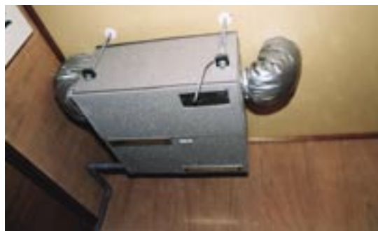
メンテナンスしやすいようユーティリティーの天井に露出状態で換気ファン本体を設置した例
