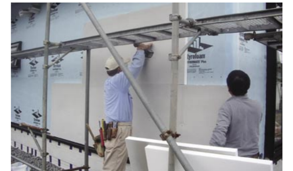
湿式外装用付加断熱パネルの試験施工を行っているところ。2008年に本格販売を予定している
