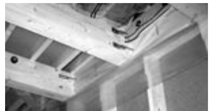
写真1・梁の脱落を防ぐため、羽子板ボルトはとにかくしっかり留め付ける
