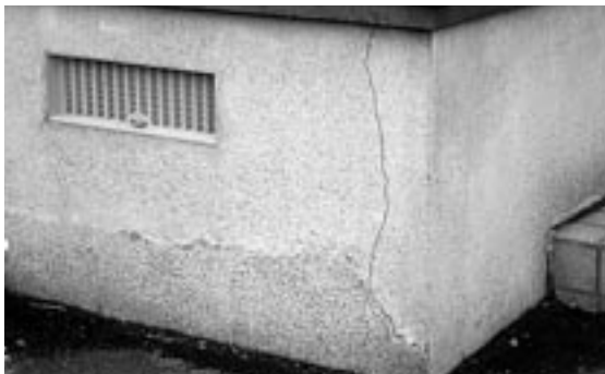
地震によってヒビ割れが発生した布基礎
