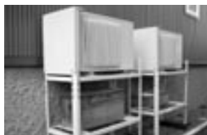
写真A・空気熱源式のエコキュートの室外機
