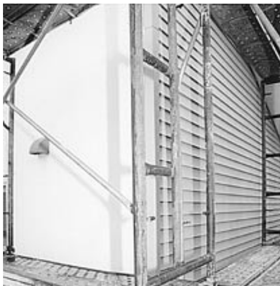
モルタルの上から通気層なしでPVCサイディングを施工している現場
