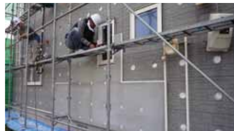
既存サイディングの上からEPSをビス・ワッシャーで通気胴縁に留め付ける
