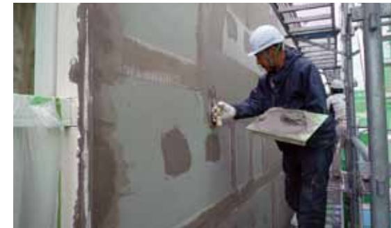
EPSのジョイント部分などはグラスファイバーメッシュとベースコートで処理
