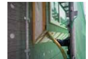
断熱材が不足していた出窓下もブローイングで断熱補強
