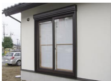
出入り可能なPVCサッシの引き違い窓にはシャッター式雨戸を取り付けている
